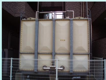
ビル等貯水タンク
